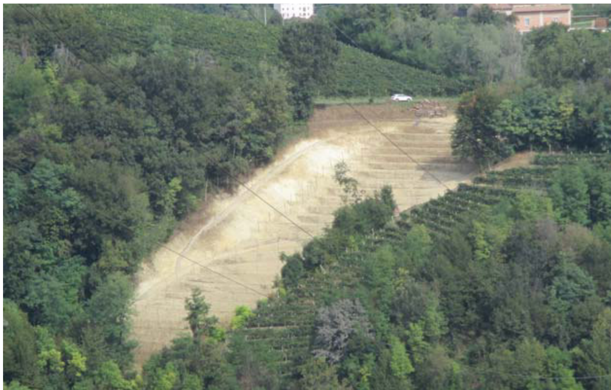
Refrontolo - sbancamenti zona Mire nel settembre del 2010
